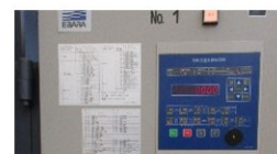
環境制御盤の導入
