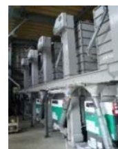
穀類乾燥調製施設
