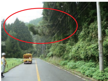
道路へ枝が張り出している状態(写真赤枠)
