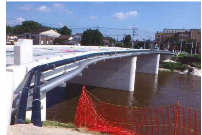
水道管の橋りょう添架
