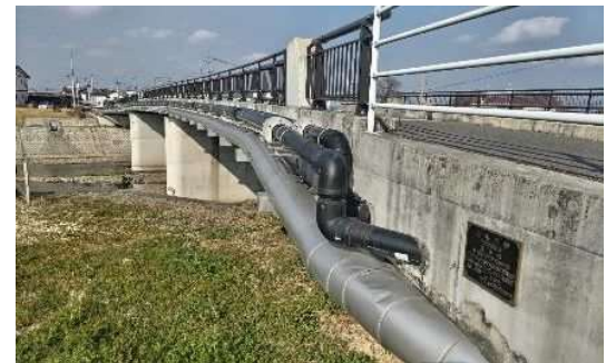
水道管の橋りょう添架
