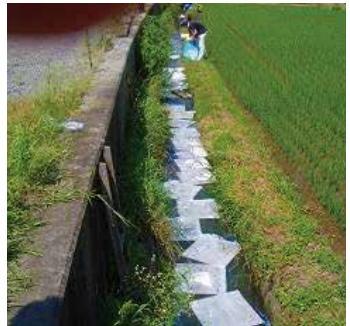
排水路から下流への油流出を防ぐため、オイル吸着マットを設置
