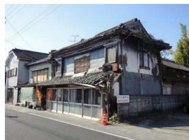
▲中心市街地内の壊れたままの建物
