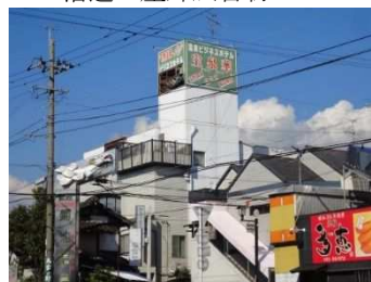
▲壊れた屋上広告物
