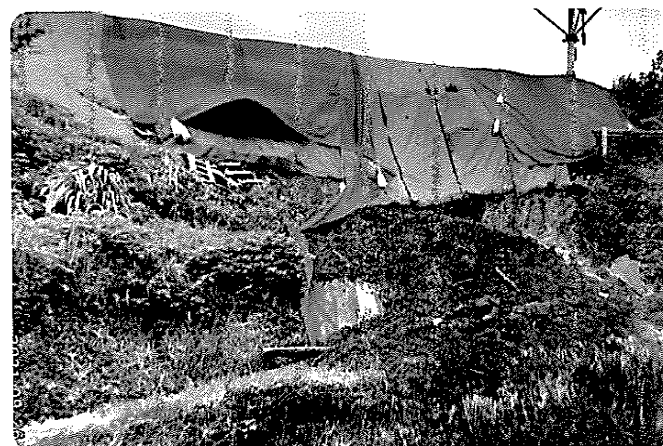
令和3年8月 豪雨の為、崩落した豊間地区 太陽光発電施設の東側斜面
