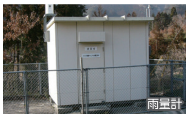
雨量レーダー
