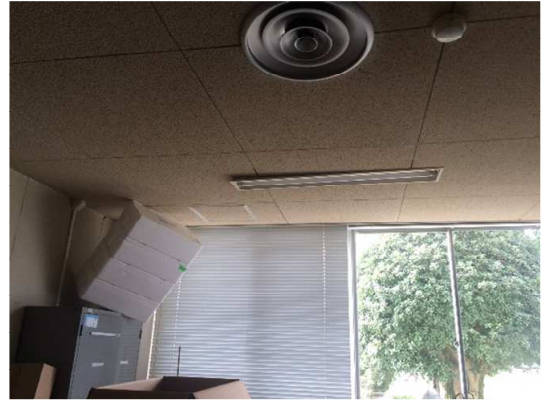
地震による蛍光灯の落下のおそれ
