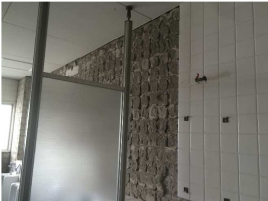
トイレの壁面タイルの剥離
