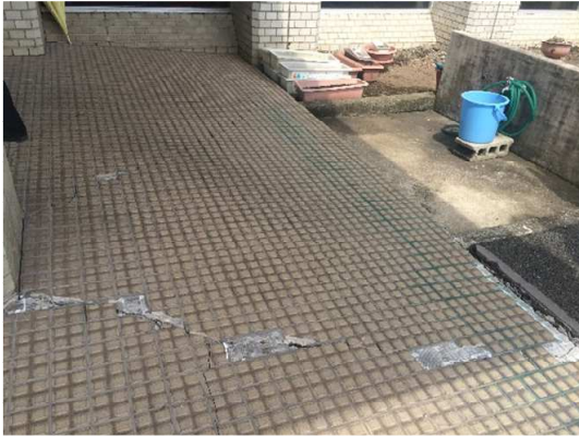
庁舎入口タイルのヒビ
