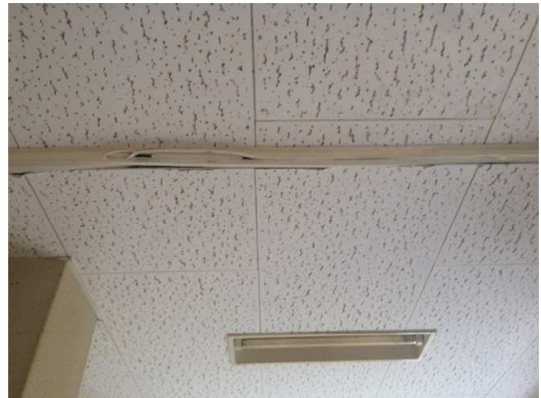
電算室と廊下結合部のずれ
