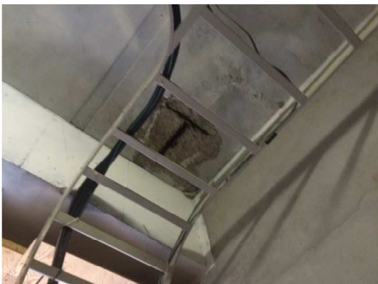
鉄筋の腐食による天井の剥落
