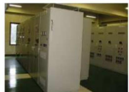
受変電設備更新 (前期実施)
