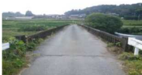
細永橋【修繕前】
