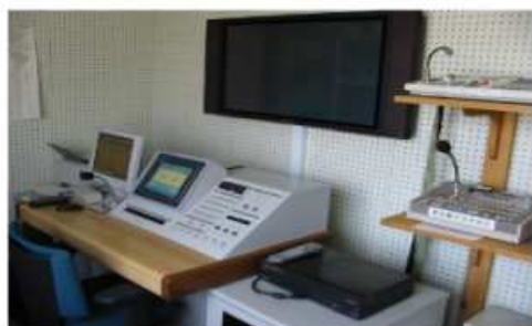
防災行政無線室
