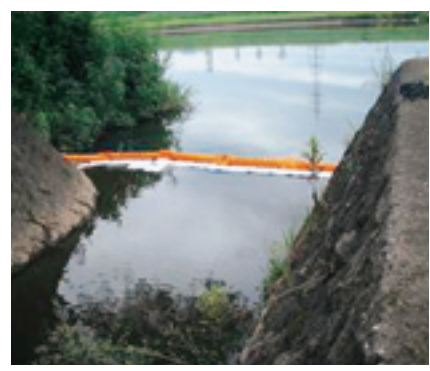
河川への油流出を防ぐため、オイルフェンスとオイル吸着マットを設置
