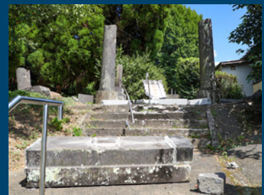
【富出分区の菅原神社】鳥居が崩れ、階段や手すりが大きく損壊
