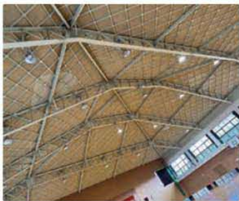
右半面のみ点灯となった七城体育館
