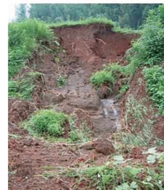
農地被災箇所
