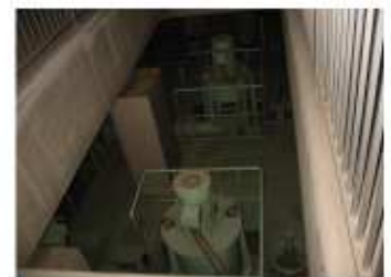
更新予定のポンプ
