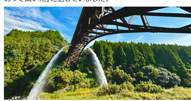
豊潤橋は車両交通を支えるだけでなく、橋の下にはパイプラインが設けられ、農業用水を供給する役割も担っています。放水は菊池台地用水土地改良区が毎年、稲刈りを終えた時期に実施しています
