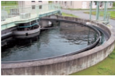
泗水浄化センターにある下水処理施設(沈殿槽)。下水道について家庭で考えてみませんか
