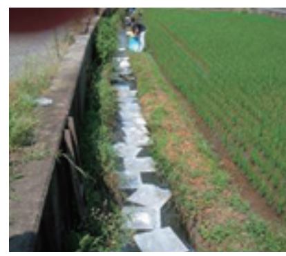
排水路から下流への油流出を防ぐため、オイル吸着マットを設置
