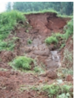
平成21年に起きた崖崩れ
