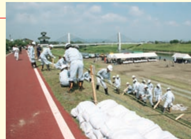
堤防の裏のり面に生じた亀裂の拡大を防ぐ「繋ぎ縫い工法」を披露する、国土交通省班の班員たち
