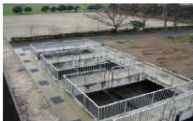
3系列最終沈殿池
