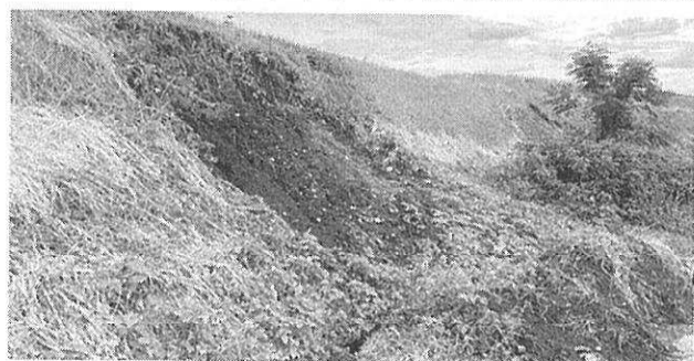
小災害復旧前
