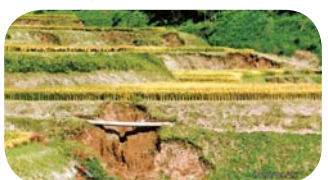
▲7月豪雨で崩壊した棚田
