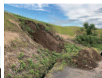
小災害復旧前
