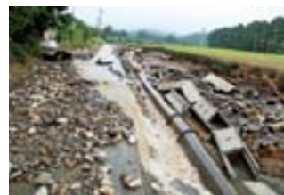
←北桜ヶ水区の被災した道路。2メートル以上洗掘され、埋設された配水管が露出している。
